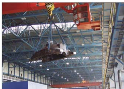
Manipulace s víkem turbíny v elektrárně Dětmorovice
