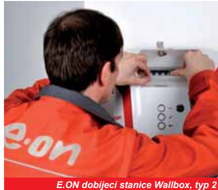
E.ON dobíjecí stanice Wallbox, typ 2
