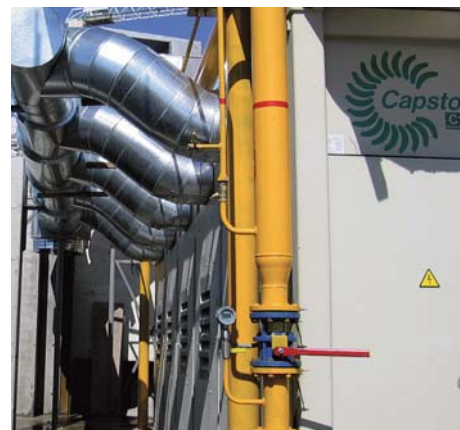
Pohled na část energetického zařízení GGC Energy v obchodně administrativním centru v ruské Soči
