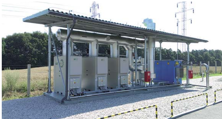
Energocentrum nové bioplynové stanice
