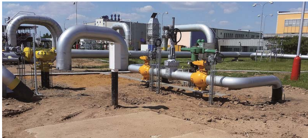
GASCONTROL se podílel například na modernizaci kompresní stanice plynu v Kouřimě pro přepravce plynu NET4GAS
