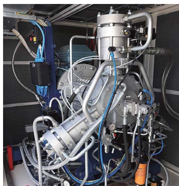
Výkonný kompresor – srdce CNG plnicí stanice
