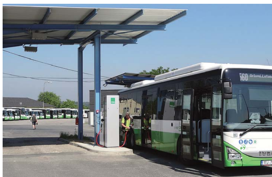
Pohled na novou plnicí stanici CNG v Orlové
