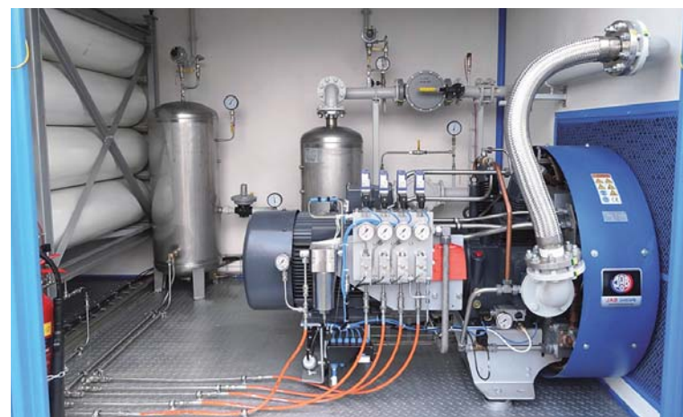
Na snímku technologie plnicí stanice CNG v Hlučíně se špičkovým výkonným kompresorem
