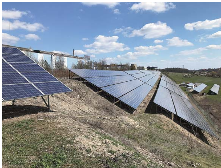
Fotovoltaická elektrárna Buštěhrad
