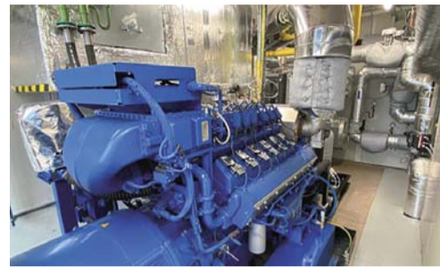
Nová kogenerační jednotka zajistí Nemocnici Jilemnice stabilní a levnější dodávky tepla
